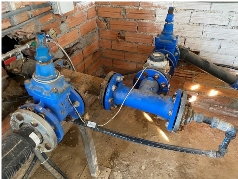
Figura 6. Vista detall de la canonada de sortida de la captació del Pou Hill.
