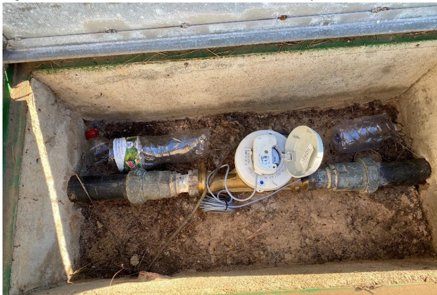
Figura 26. Vista d'una de les canonades de sortida del Dipòsit de les Costes.
