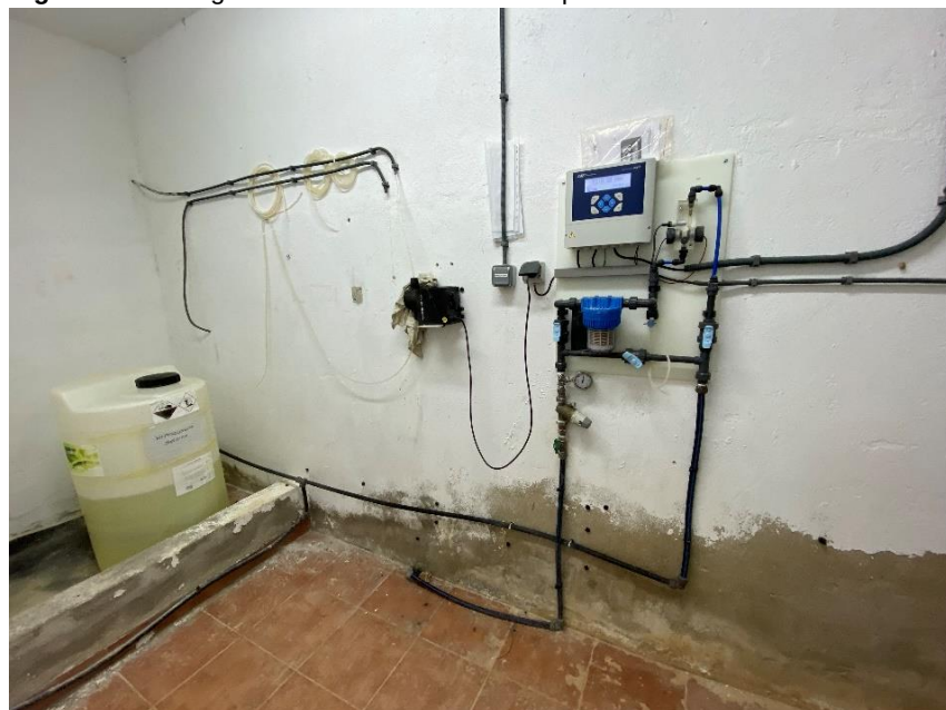
Figura 13. Vista general de la cloració en el Dipòsit Plana de les Torres.
