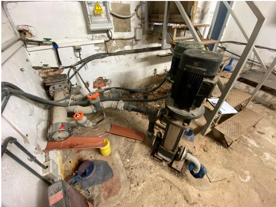
Figura 9. Vista detall de la canonada de sortida de la captació de la Mina de les Dous juntament amb les dues bombes que impulsen l'aigua a través d'aquesta sortida.
