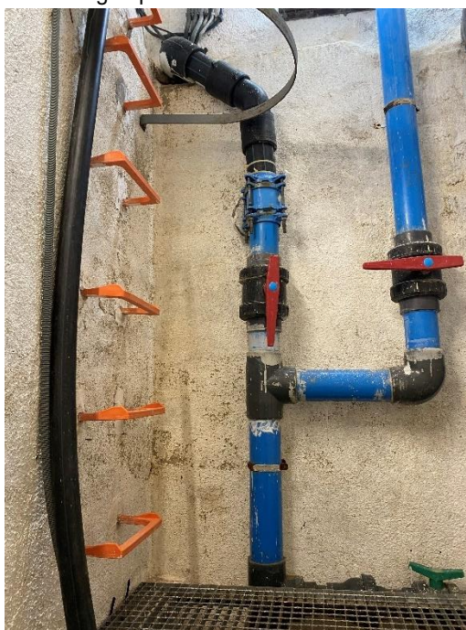
Figura 25. Vista de l'entrada d'aigua provinent de la mina de les Dous al Dipòsit de les Costes.
