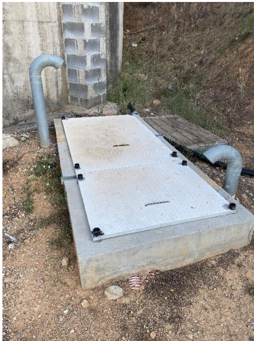
Figura 24. Vista de l'entrada d'aigua provinent d'Aigües Ter – Llobregat al Dipòsit de les Costes.
