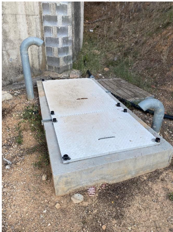
Figura 10. Vista de la canonada de les aportacions externes d'ATLL.
