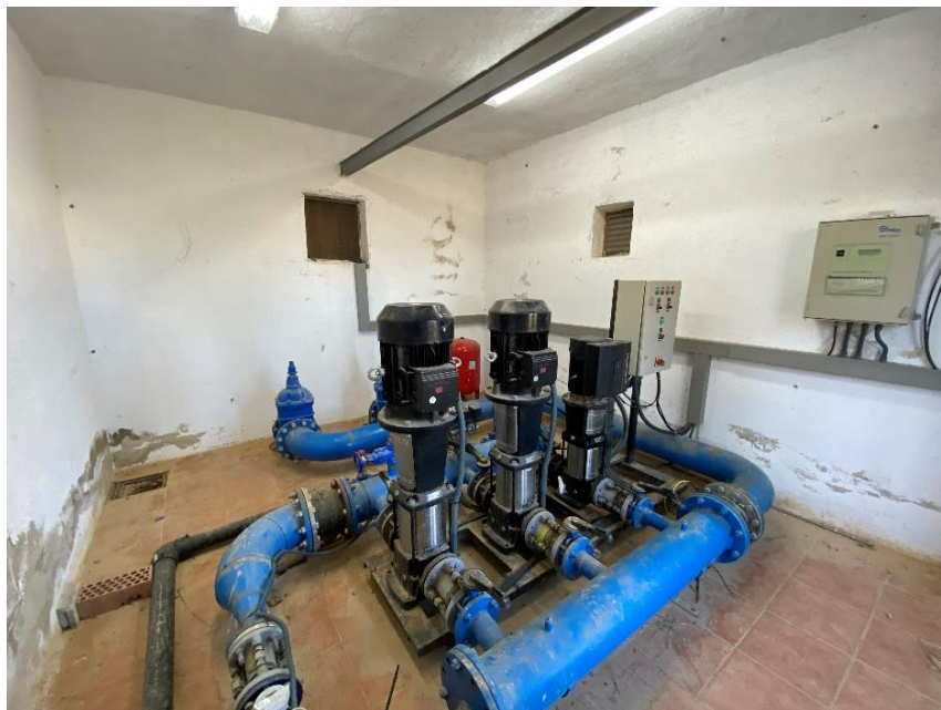
Figura 12. Vista general del circuit d'aigües a l'interior del dipòsit amb les 3 bombes, canonades d'entrada i de sortida.
