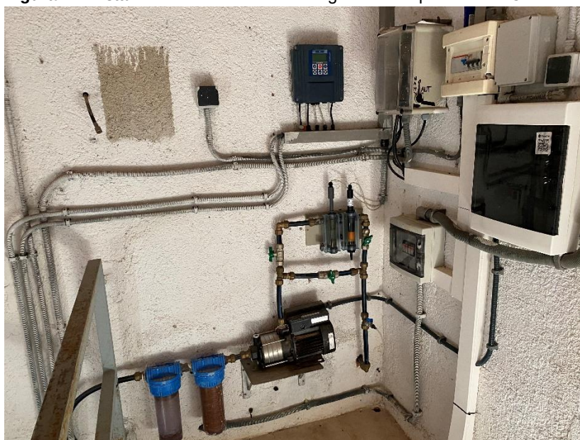
Figura 27. Vista detall de la cloració de l'aigua en el Dipòsit de les Costes.
