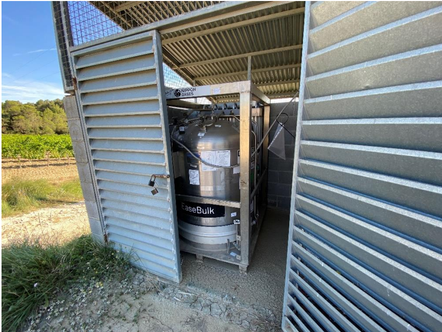
Figura 5. Vista detall del dipòsit de CO 2 de la captació del Pou Hill.
