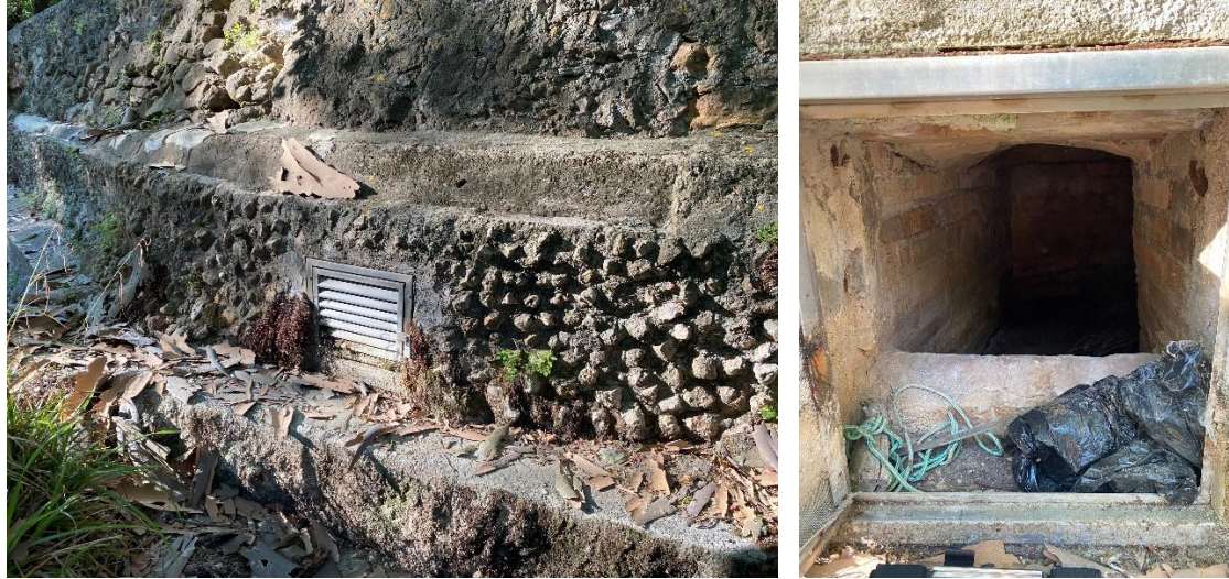
Figura 8. Vista detall de les canonades que recullen l'aigua i la transporten fins al petit dipòsit de l'estació de bombeig de la Mina de les Dous.
