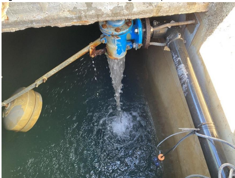
Figura 16. Vista detall de l'entrada d'aigua del Dipòsit de Can Coral.
