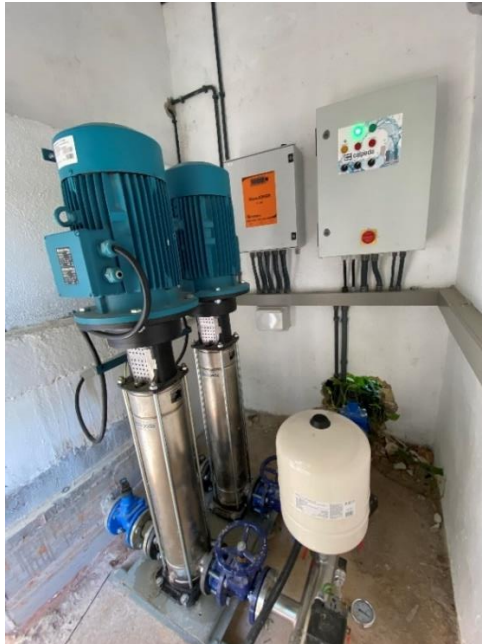
Figura 21. Vista detall de la sortida d'aigua del Dipòsit de Gatell juntament amb les bombes impulsores.
