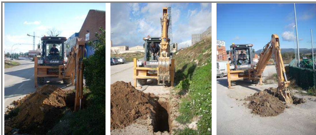
Vistes parcials dels sectors afectats
